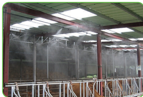
〈축사 내부 스프링쿨러〉
